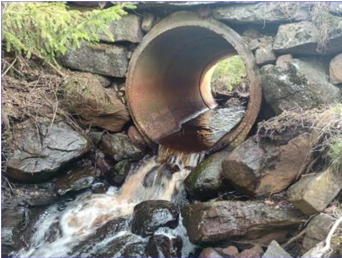
Figur 71: Vandringshinder nummer 9 består av en vägtrumma med ett fall vid utloppet.
